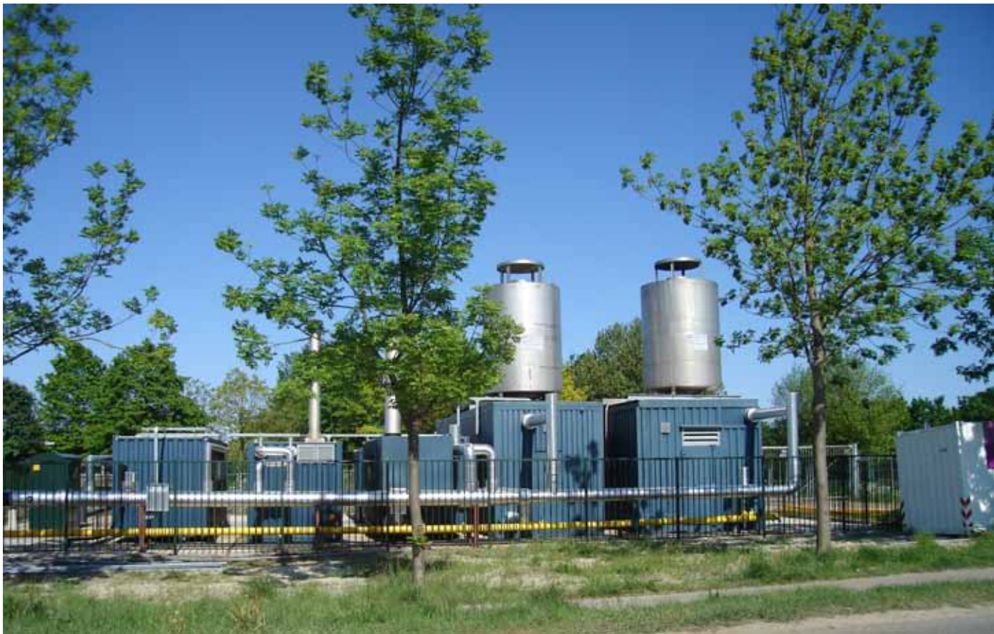
Tijdelijke WarmteCentrale Nijmegen Noord.
